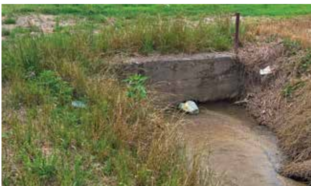
Esempio di accesso carraio con tombino ostruito e sottodimensionato
