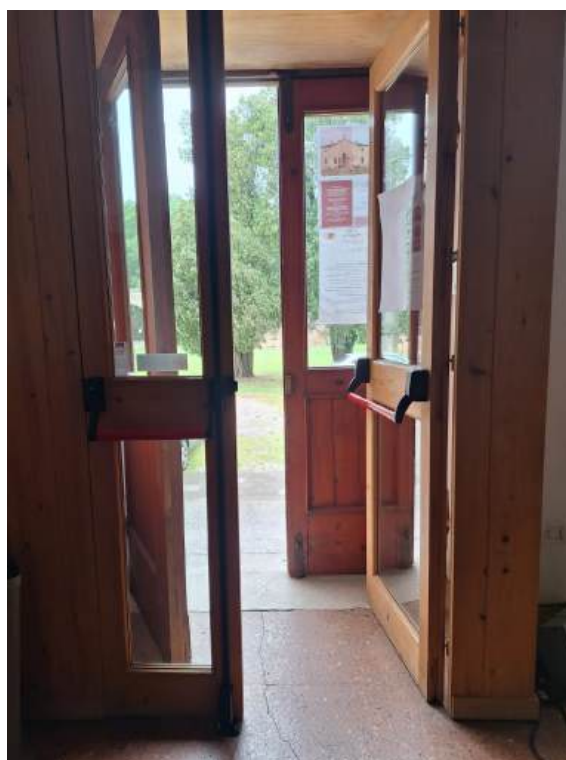
CRITICITA' 5 – Vista della doppia porta di ingresso in corrispondenza della biglietteria
