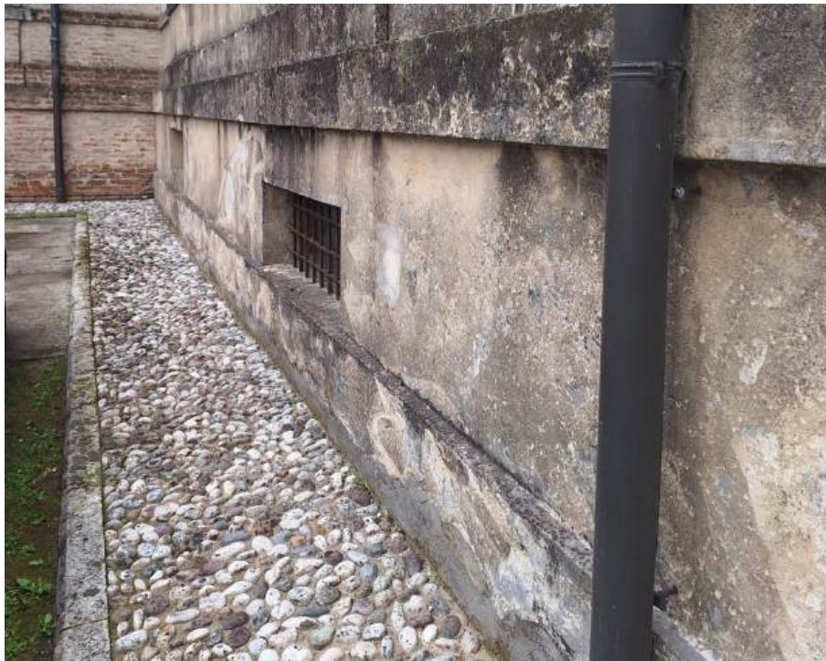
CRITICITA' 8 – Vista del marciapiede intorno alla Villa
